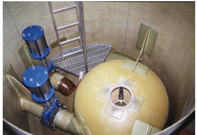
Figur 5 MFT Virvelkammerkum med virvelkammer av typen FluidCon HSUt og automatisk vannstyrt avstegningsventil
