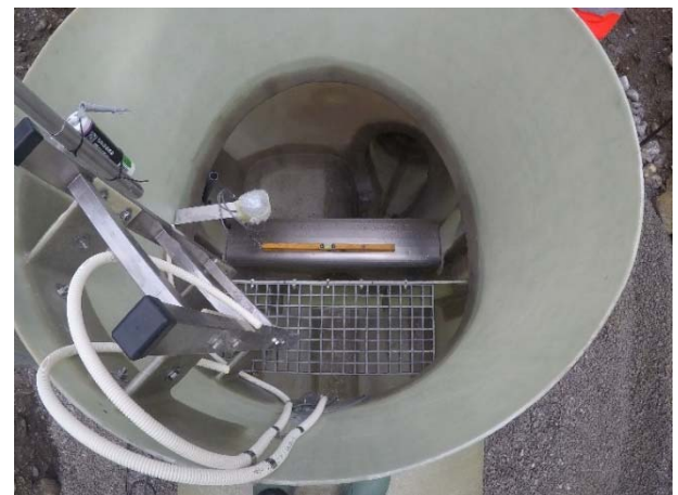
Tverroverløp med kalibrert terskel for registrering av overløpsutslipp
