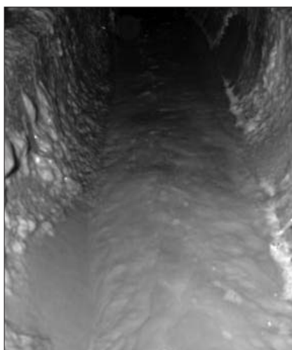
Figur 4. Innvendig begroing i AF ledning
