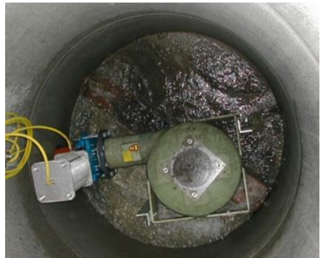
Figur 1 Installasjon av FluidCon i sirkulær betongkum
