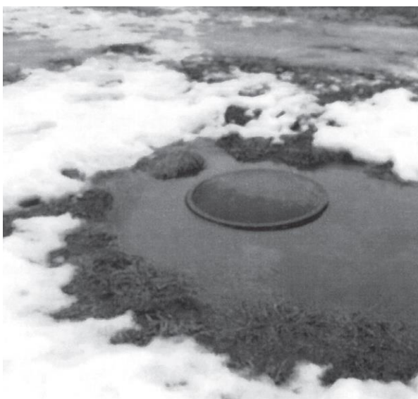
Figur 10 Resultatet av feil avrenning overflatevann
