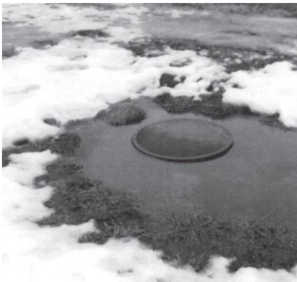
Figur 10 Resultatet av feil avrenning overflatevann
