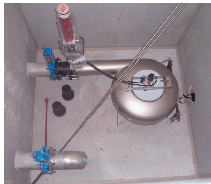
Bild 5: Eingebaute Turbo-Wirbeldrossel UFT-FluidTurbo DN 150 in einem Betonbauwerk. Der Profilbeton und die Spindelverlängerungen zur Schieberbetätigung fehlen hier noch.
