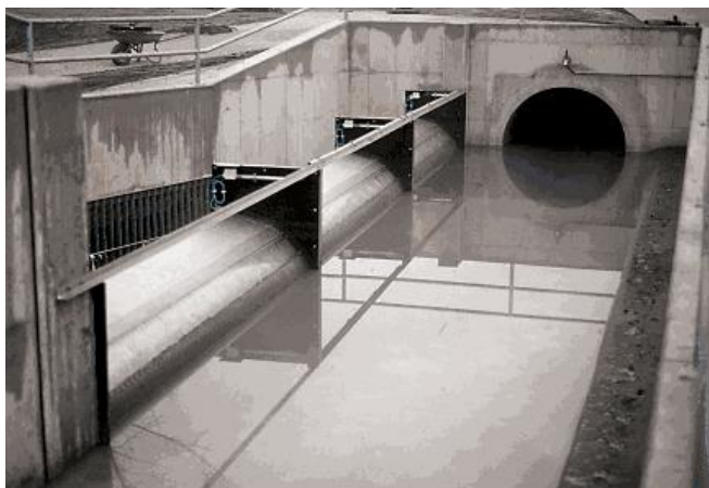
FluidBend - nødoverløp i fellesystemet
